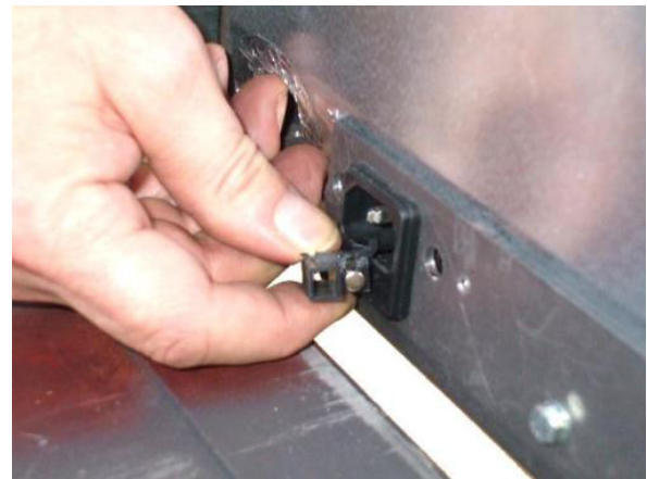
Fig. 56 - Vervanging van de zekering
