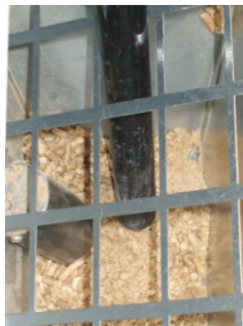
Fig. 55 - Reiniging van de voorraadbak en transportschroef
