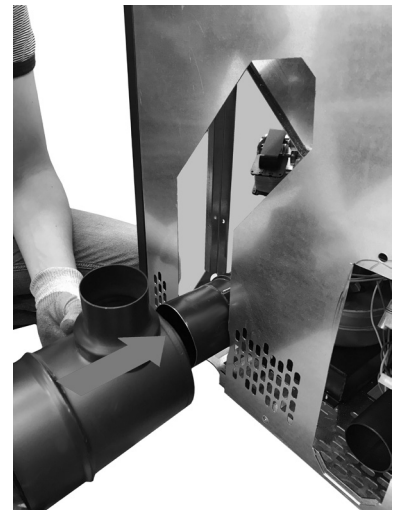
Fig. 42 - Concentrische buis aansluiten
