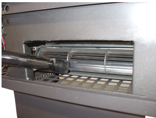
Fig. 40 - Room fan cleaning
