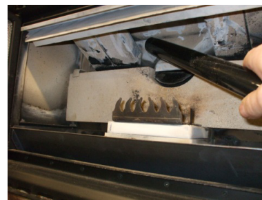
Fig. 38 - Nettoyage de la partie supérieure des tuyaux dans la chambre de combustion
