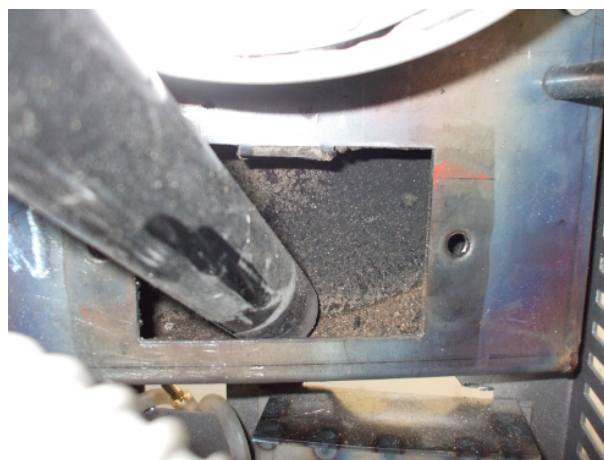
Fig. 35 - Pulizia camera fumi
