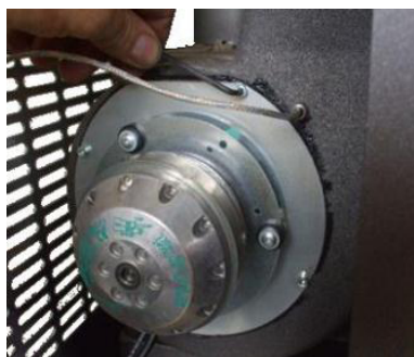
Fig. 37 - Pulizia aspiratore fumi: fase 1
