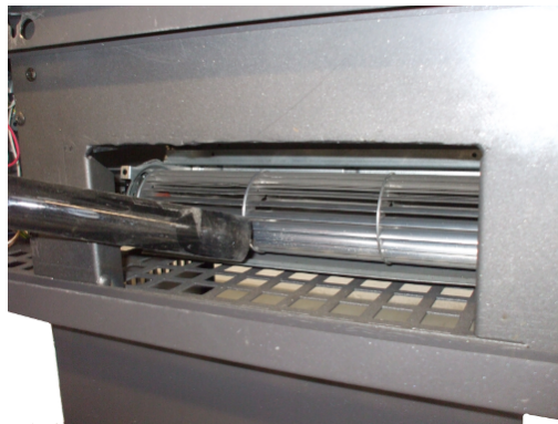
Fig. 40 - Nettoyage de le ventilateur ambiant
