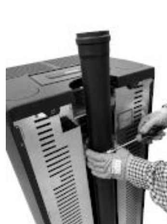
Fig. 59 - Rookgassenafvoer achteraan gemonteerd
