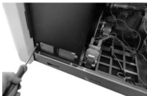
Fig. 107 - Nettoyage de le ventilateur ambiant
