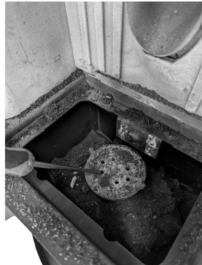
Fig. 37 - het schoonmaken van de vuurpot
