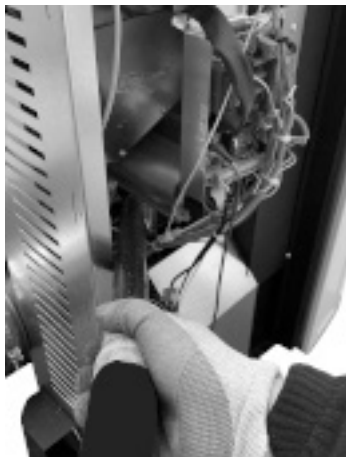
Fig. 57 - Reiniging van de kamerventilator
