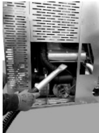
Fig. 58 - Reiniging van de kamerventilator 2
