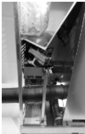
Fig. 56 - Sortie de fumées postérieure Sharp
